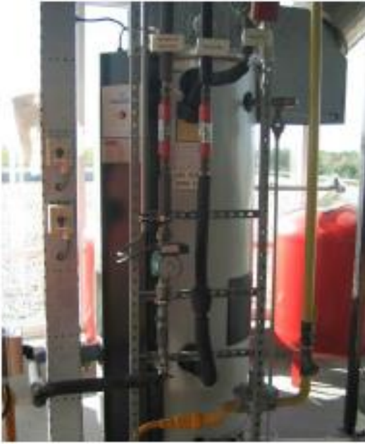
Afb. 15 Boiler met circulatieleiding
